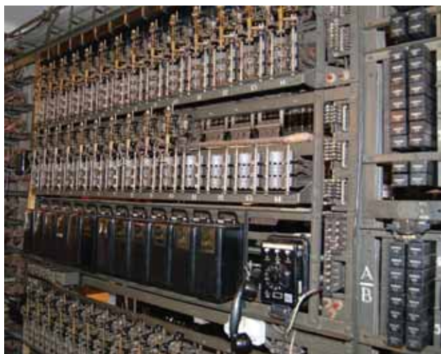
Töölön puhelinkeskuksen Strowger-keskuslaitteita Puhelinmuseolla.
