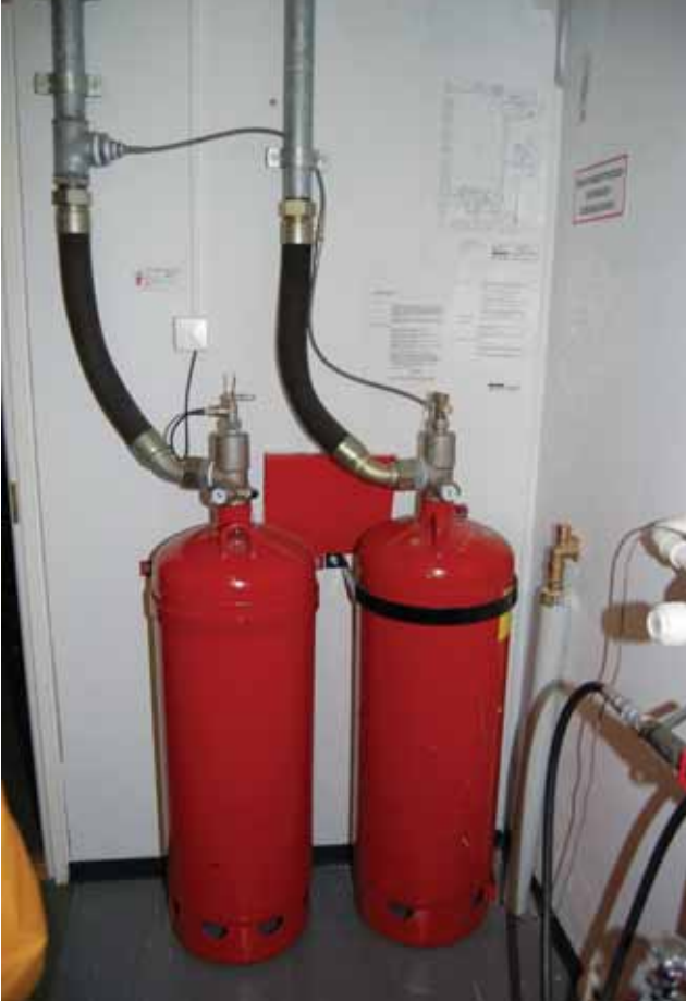
Halonisammutusjärjestelmä suojaa ristikytkentähuonetta sammuttamalla tulipalot jo alkuunsa.
