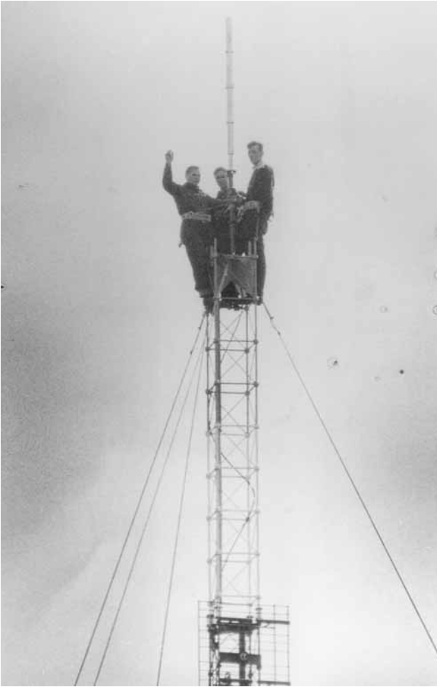
Korkeavuorenkadun keskuksen vanha radiomasto, joka on purettu ja korvattu uudella korkeammalla mastolla. (Kuva: Puhelinmuseo / Erkki Lahtinen)
