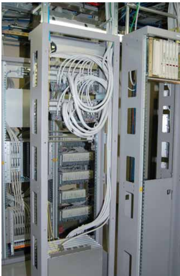
Töölön nykyisen toimivan puhelinkeskuksen laitteista.
