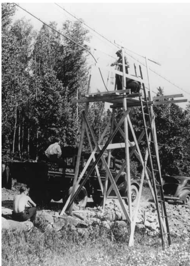
Helsingin puhelinyhdistyksen kuorma-auto ja kevyt asennusauto linjanrakennustöissä ilmeisesti 1930-luvun lopulla. (Puhelinmuseo / Erkki Lahtinen)
